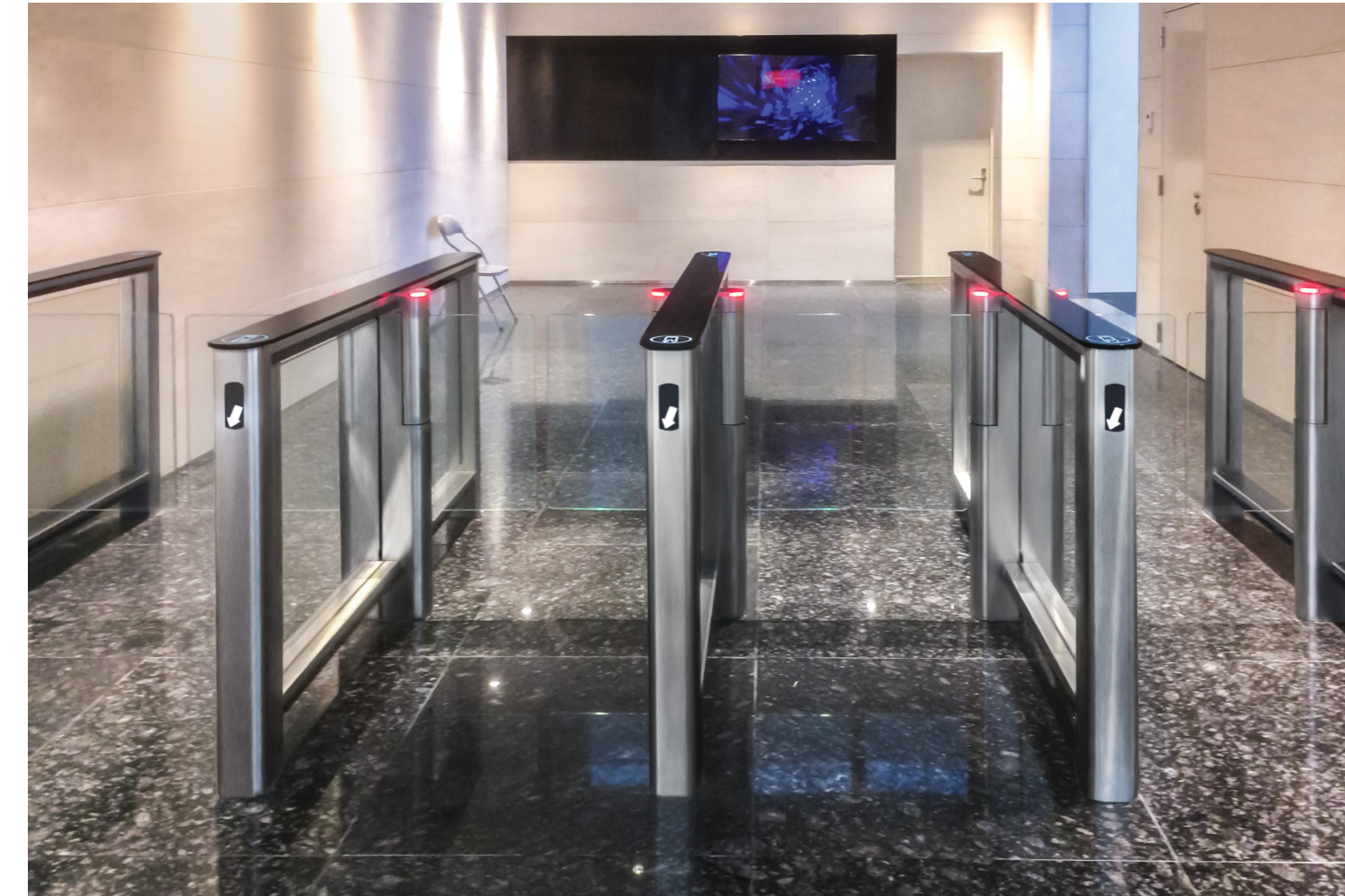
Pasillos rápidos ST-01, Centro de Televisión QPVN, Vietnam
